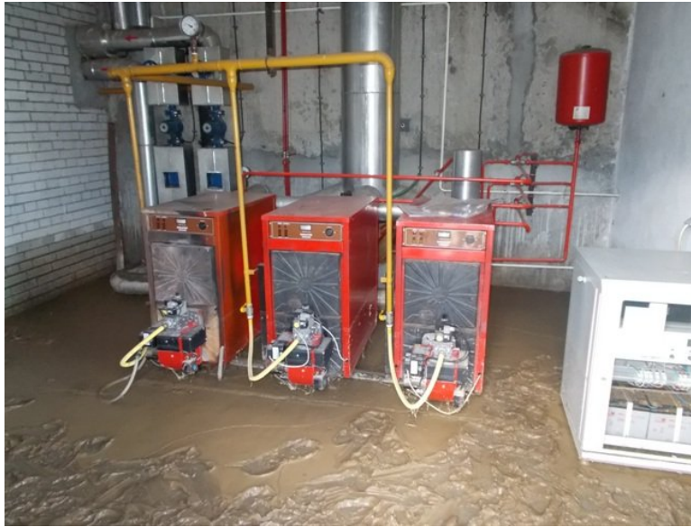
ГМРС Горњи Миловац - котларница
