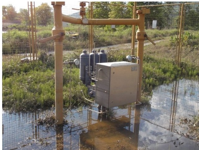
ГМРС Трстеник – блок вентил
